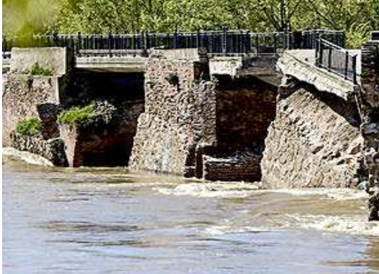
El agua provocó cuantiosos daños materiales.
