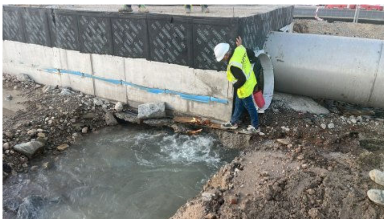
Rotura de una tubería de abastecimiento de agua en Almería por las obras del soterramiento, este lunes 31 de marzo. Ayuntamiento de Almería
